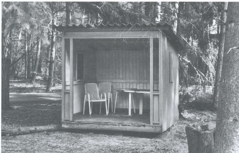
T.B.C.-huisje op het terrein. Restauratie is op korte termijn dringend nodig (foto Jaap Kruidenier)
